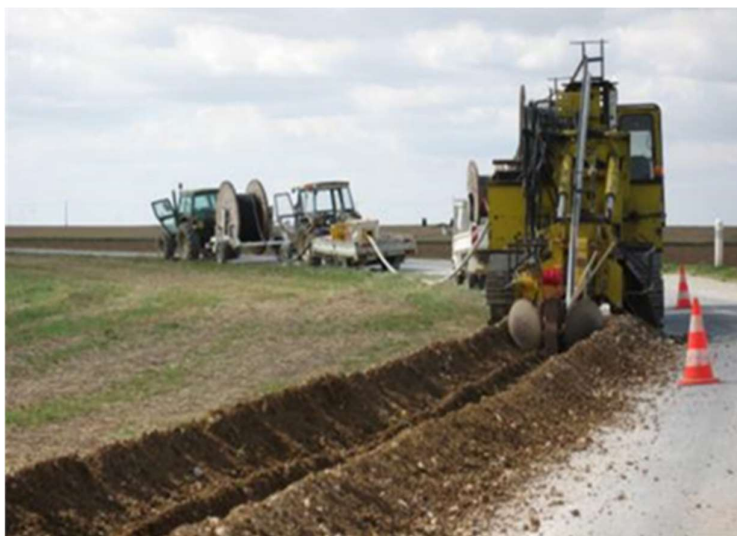
Figure 9 : Réalisation d'une tranchée de raccordement en accotement d'une route (Source : EDF Renouvelables)
